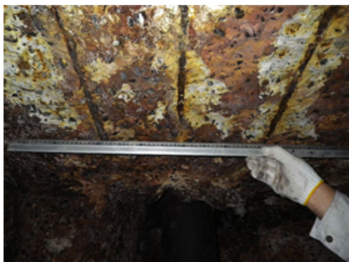
劣化したコンクリート
